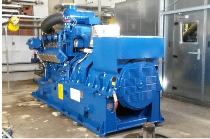
BHKW-Modul vor Endmontage
